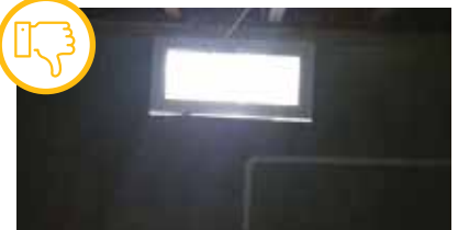
Instalación de ventana sin sello y encaje inapropiado.
